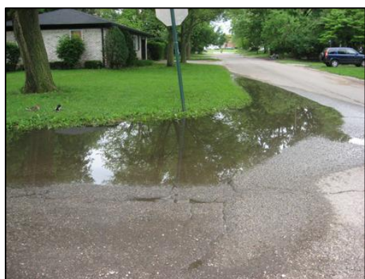
Den øgede nedbørsmængde er hård kost for vore kloakanlæg og betyder skader i millionklassen for både det offentlig og private. Ovenstående billeder er ikke unikke, men kan ses overalt selv efter moderate regnvejrskdage.
